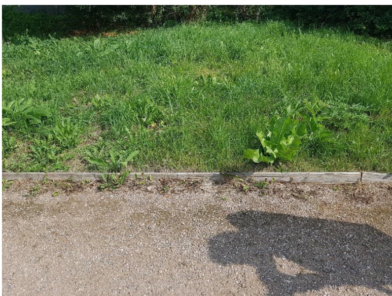
Fot. 35. Widok obrzeża drewnianego nad stawem nr 3 -żwir do oczyszczenia i uzupełnienia.
