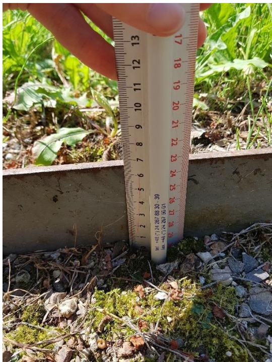
Fot. 27 Miejsce znaczne ubytki materiału nawierzchni.
