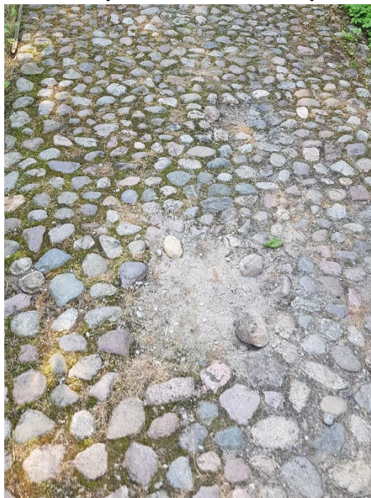
Fot. 37. Fragmenty uszkodzenia alejki z kamienia polnego przy gościńcu ogrodnika.
