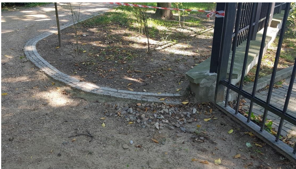
Fot. 21. Typ nawierzchni nr 3. Widoczne uszkodzenia i wypłukanie materiału nawierzchni.
