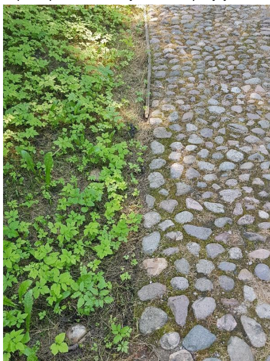
Fot. 36. Uszkodzone obrzeże z deski dębowej.
