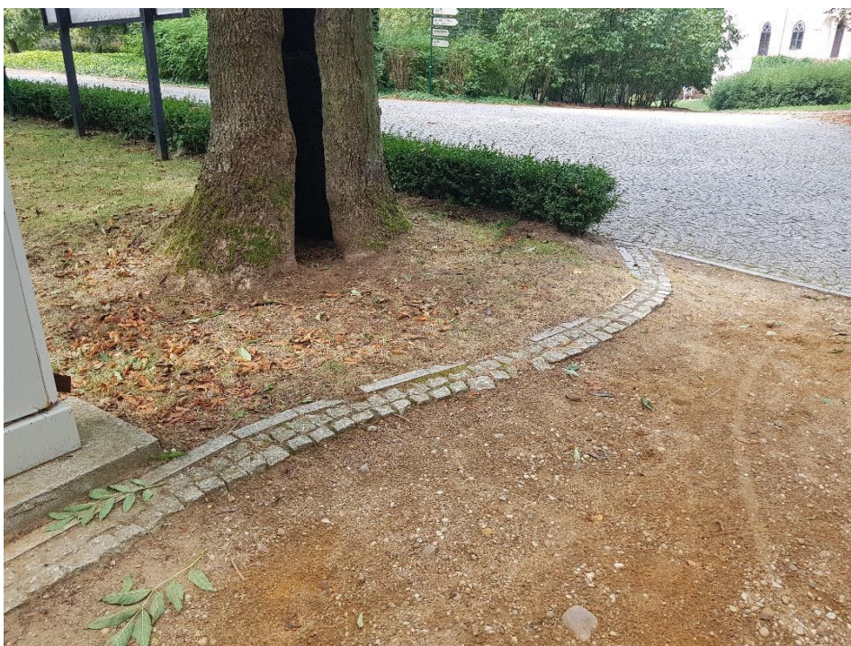
Fot. 6. Placyk informatorium przy wejściu głównym do Muzeum Romantyzmu. Wypłukane warstwy nawierzchniowe do podbudowy. Lokalne uszkodzenia obrzeży.
