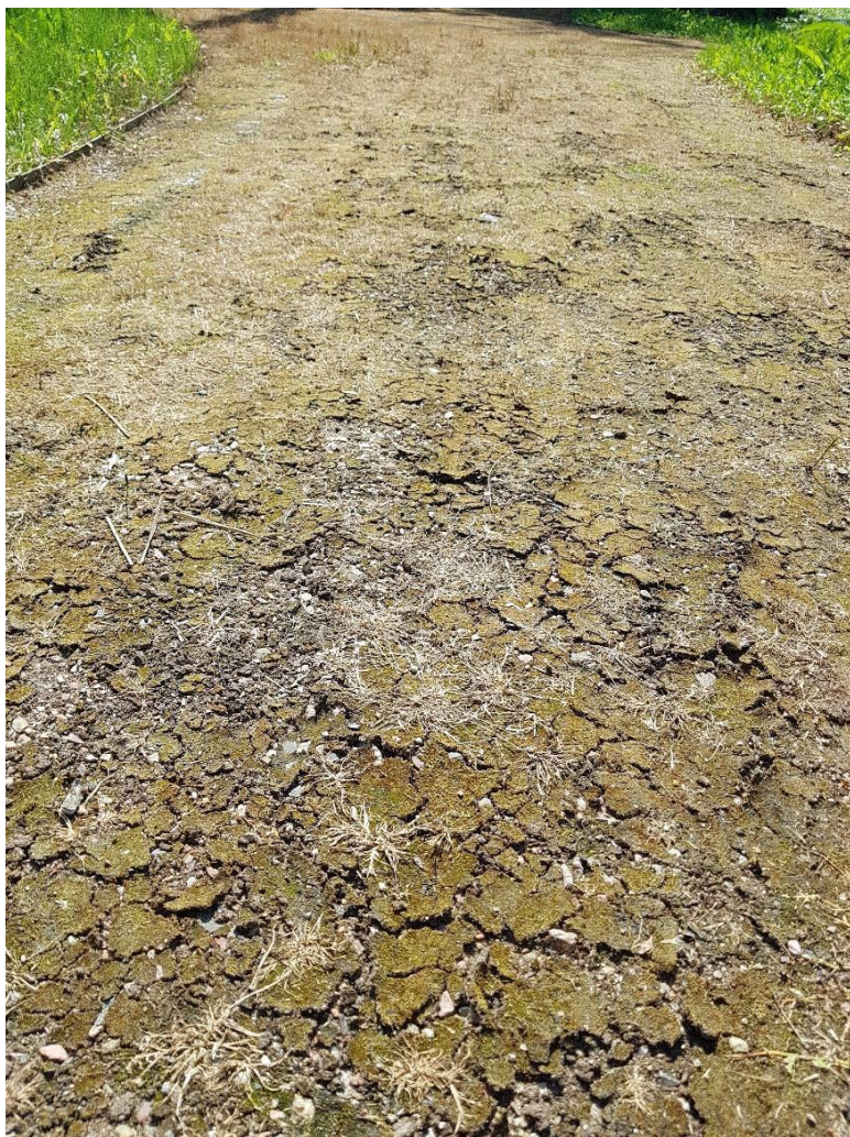
Fot. 24 Porastanie mchami nawierzchni alejek w części zachodniej parku. Wystające obrzeża metalowe- ubytki mieszanki nawierzchni ok. 1,5cm.
